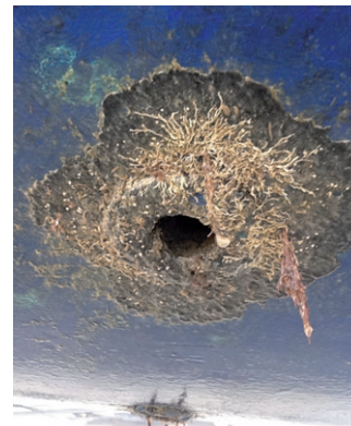
Fouling su una presa a mare metallica.
