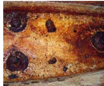
Bulloni fortemente corrosi.
